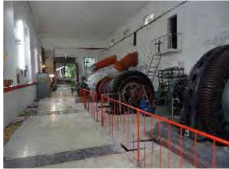
Foto 12. Planta hidroeléctrica de El Salto. Foto: Magdalena García, 2018.
